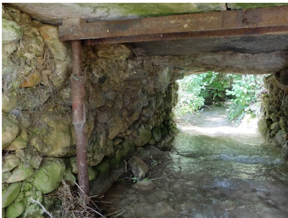
Pont du Crozarieu à refaire
