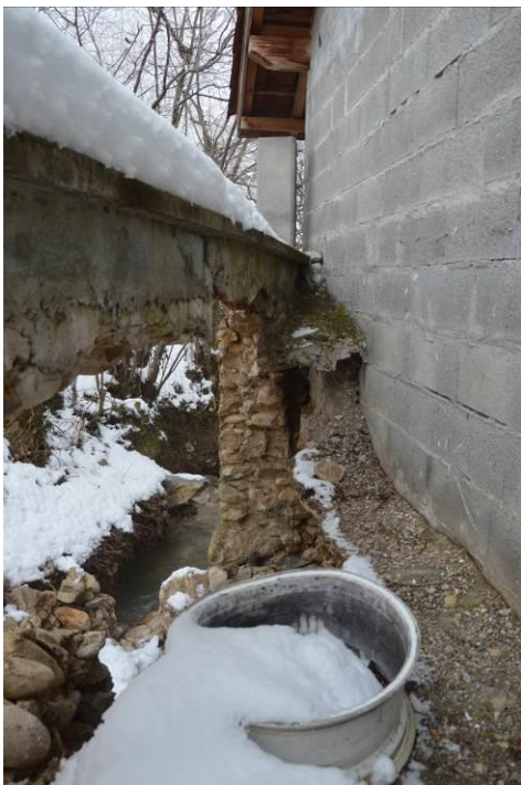
Mur effondré dans le cours d'eau.
